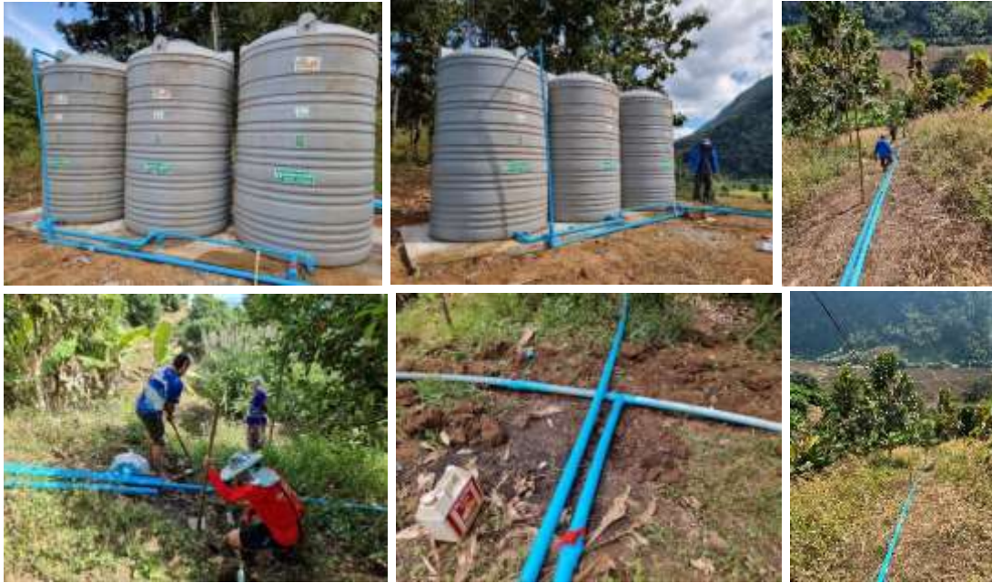
รูปภาพ : การติดตั้งระบบสูบน้ำพลังงานแสงอาทิตย์
